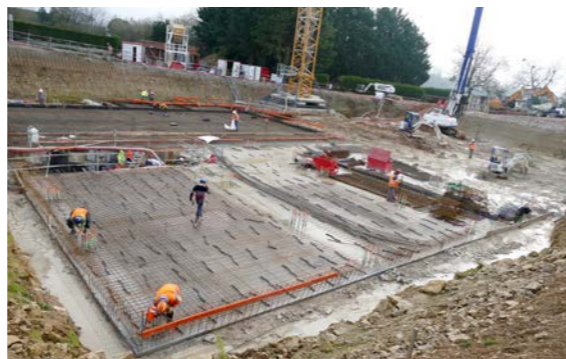
Les travaux, débutés au printemps dernier, devraient se terminer au début de l'année 2020.
