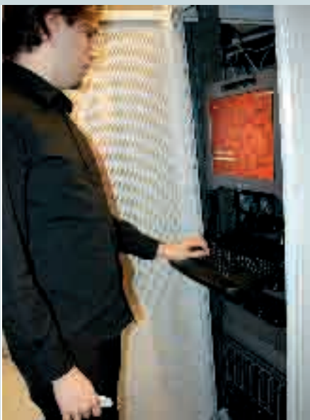
Au cœur du centre d'hébergement des serveurs informatiques. Le Data Center d'AZNetwork peut héberger et surveiller 1 000 serveurs.
