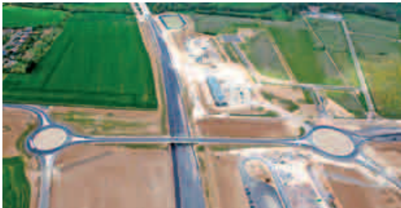
Les travaux de l'A 88 entre Argentan et Falaise s'achèvent. Ouverture du tronçon fin août.
